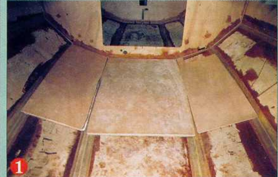
1 On colle les planches de renfort là où vient la structure métallique. Ses bords sont arasés pour épouser parfaitement les bouchains.
