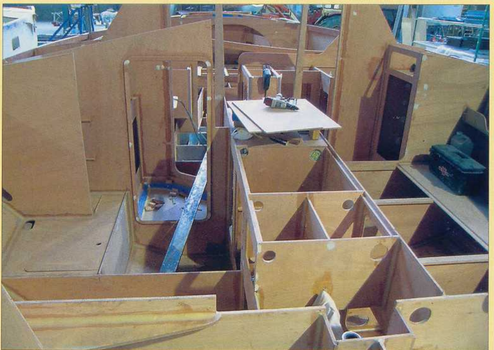
Vu depuis l'arrière, on comprend que le local technique, sur bâbord, n'a pas besoin des mêmes renforts que la cabine arrière, sur tribord, avec sa couchette double.
